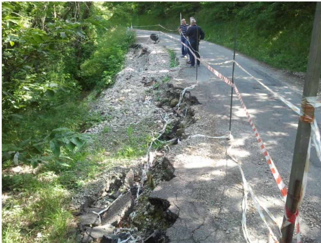
Fig 5. Vista del cedimento in strada
